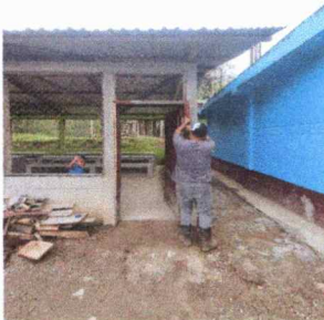
Foto 7: Viendo que la puerta de madera del comedor del establecimiento se encuentra en muy mal estado se decidió cambiarla por una de metal.
